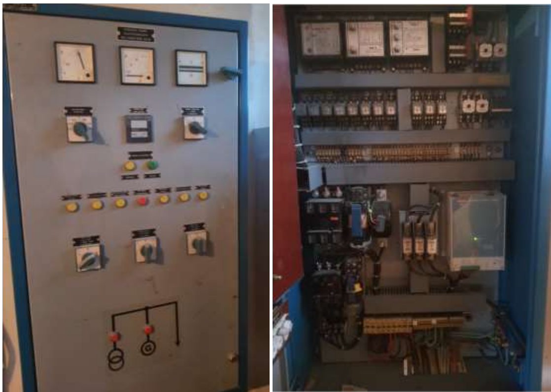
Slika 1: Komandni ormar elektroagregata
